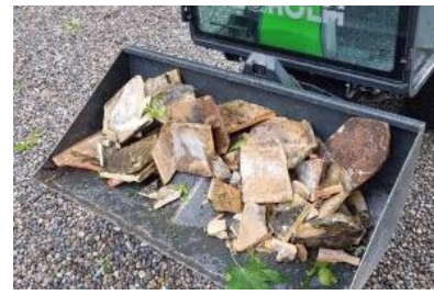
Aufräumarbeiten der Sturmschäden
